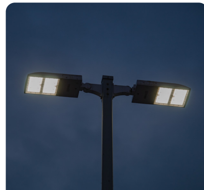
FL04B Éclairage de périmètre
